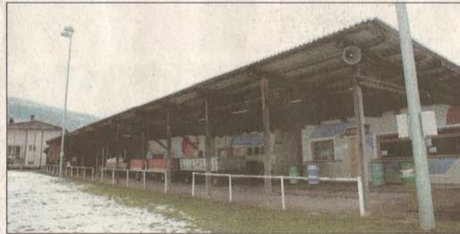
Les installations du Football-Club Glovelier tombent en ruine. PHOTO AB
